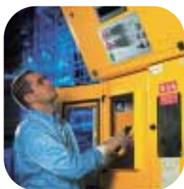
➤ "Gas cabinet", armoire de distribution des gaz spéciaux
