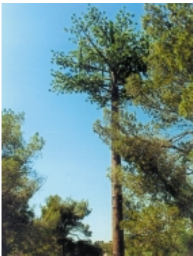
Bouygues Telecom cache ses équipements, grâce à des pylônes-arbres, par exemple.
