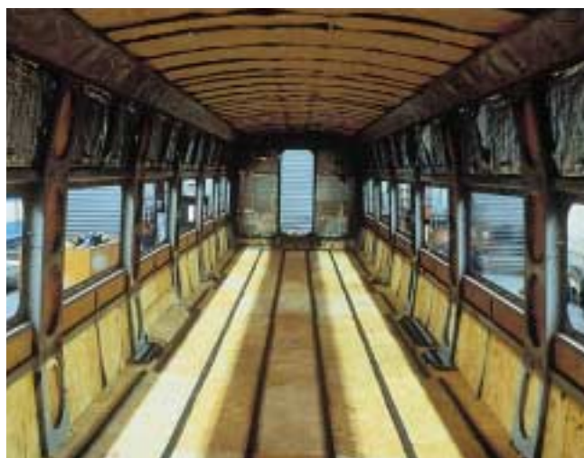
Isolation des cabines du funiculaire de Tignes.
