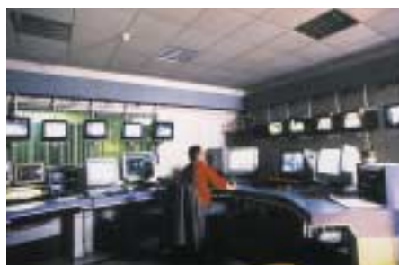
Salle de contrôle des hauts fourneaux à l'usine de Pont-à-Mousson (Meurthe-et-Moselle).
