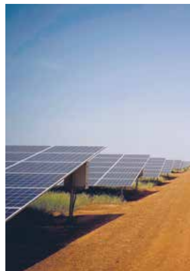
Au Sénégal, mise en service de la centrale photovoltaïque Senergy II de Bokhol, d'une puissance de 20 MW.
